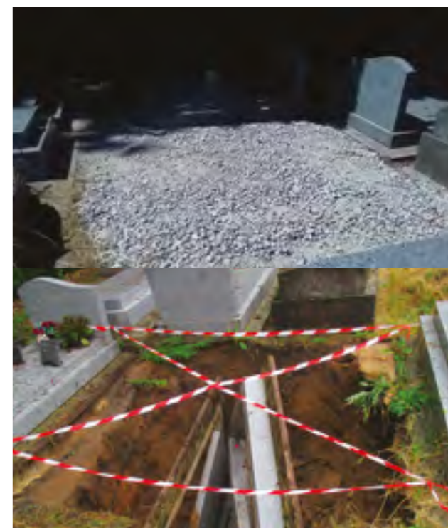
Apparition d'un fontis dans le cimetière parisien de Bagneux et excavation rebouchée avec de la grave avant traitement du fontis par injection
