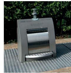
1 PAVE (Point d'Apport Volontaire Enterré) d'une capacité de 5 m 3 (pour les OM et les emballages recyclés ; 3 m 3 pour le verre en raison du poids)
