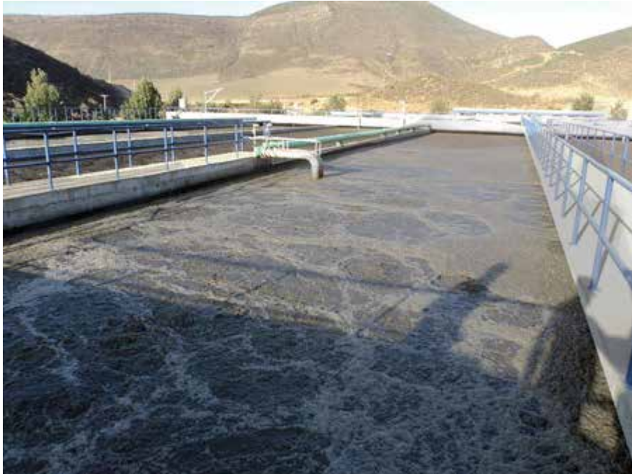
Zanjas de oxidación
