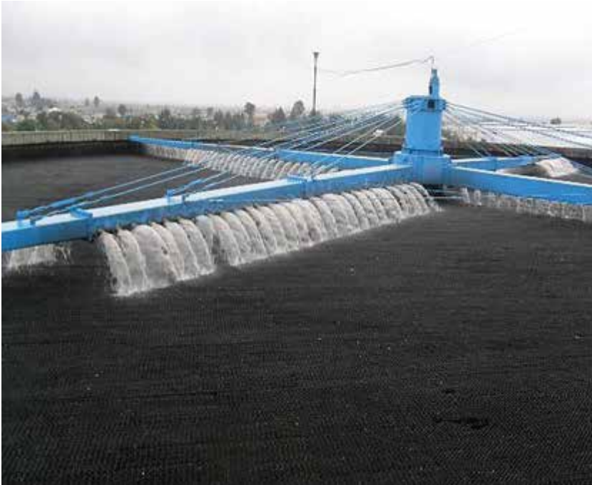
Filtro biológico (percolador)
