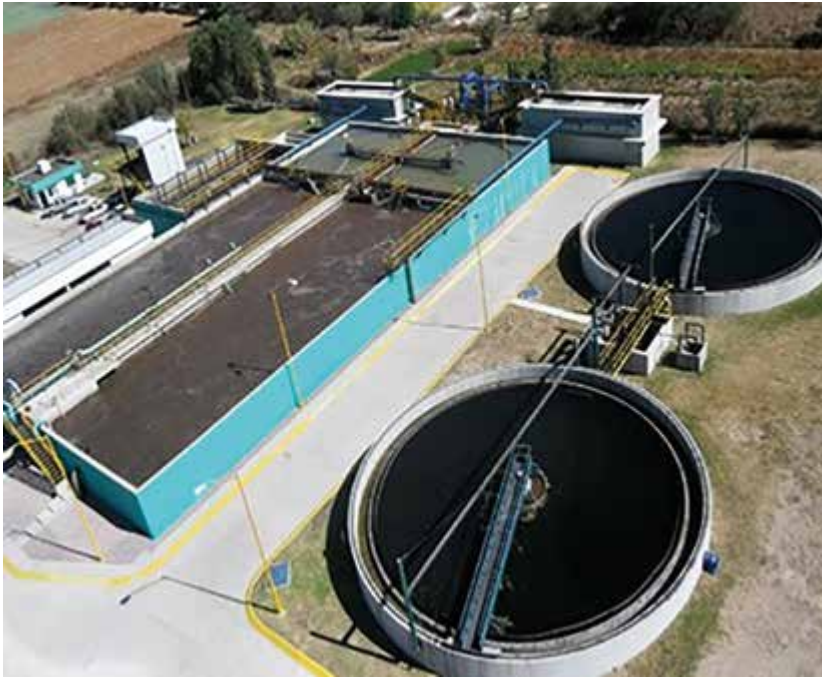
Reactores aerobios y sedimentadores secundarios
