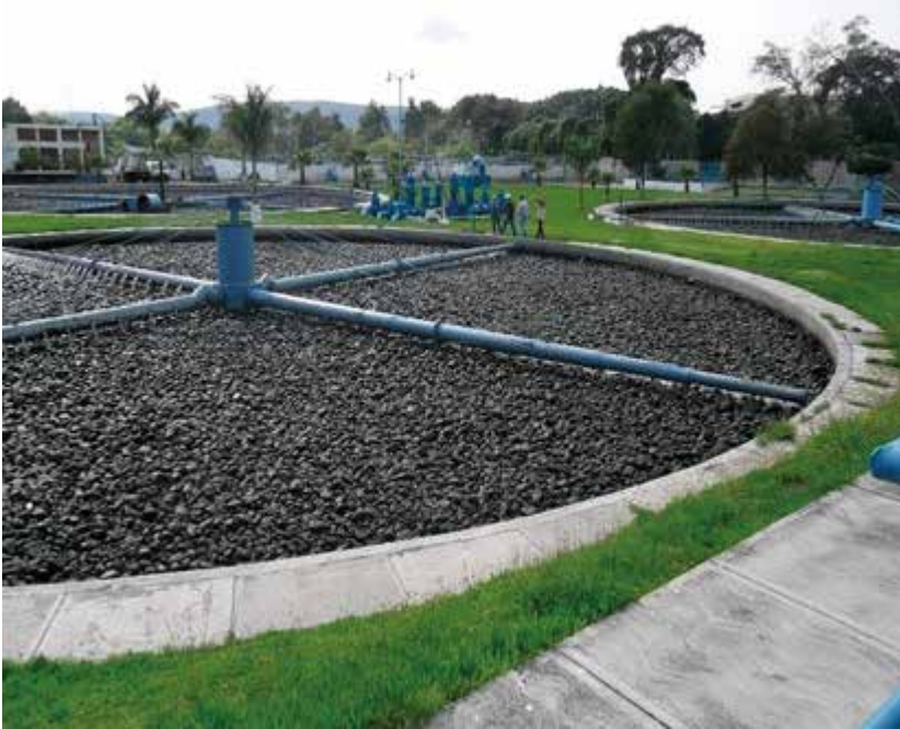
Filtro Biológico (percolador)
