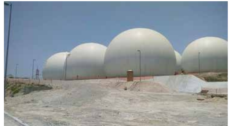
Almacenamiento de biogás
