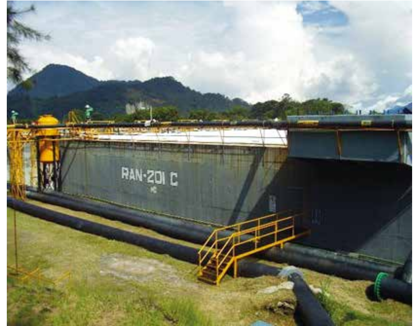
Reactor Anaerobio de Flujo Ascendente
