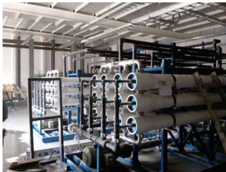
Sistema de ósmosis inversa
