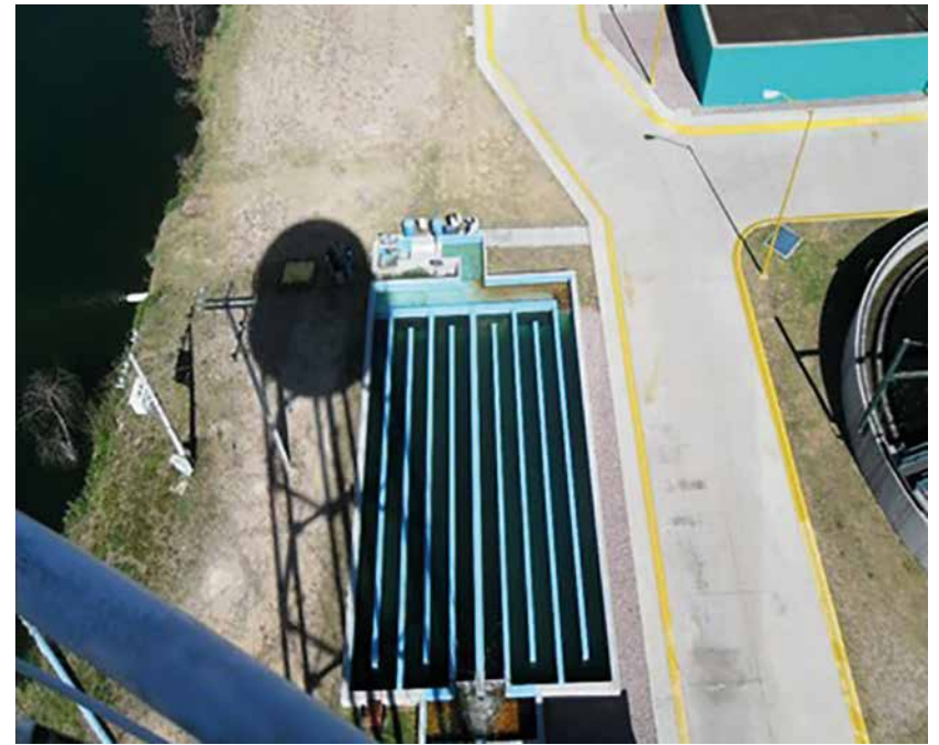
Tanque de contacto con cloro
