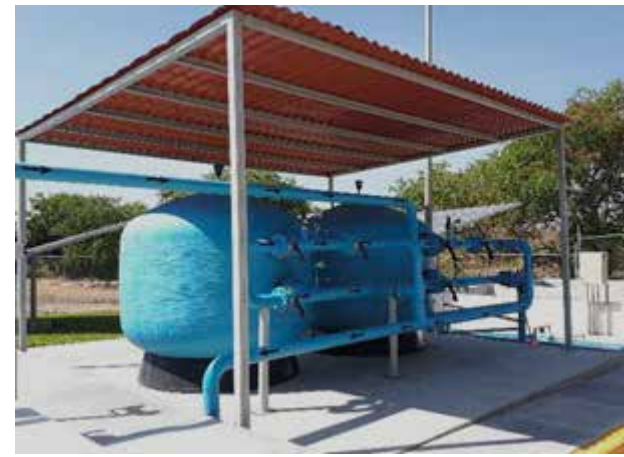
Filtro de arena
