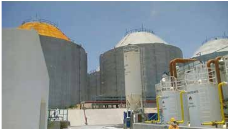
Digestor anaerobio de lodos
